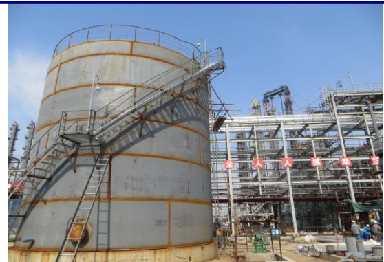
烯烃分离装置碱液罐
