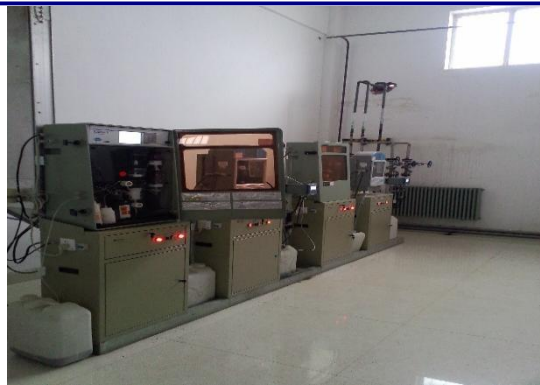
污水连续自动在线监测设备间
