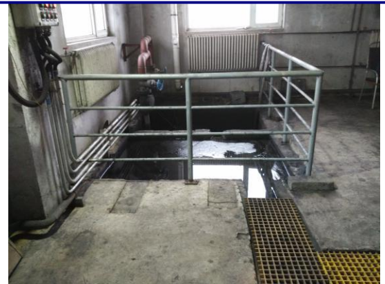
输煤栈桥冲洗废水集水池
