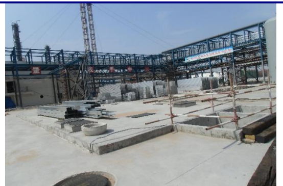
聚丙烯精制单元设备冲洗水收集池
