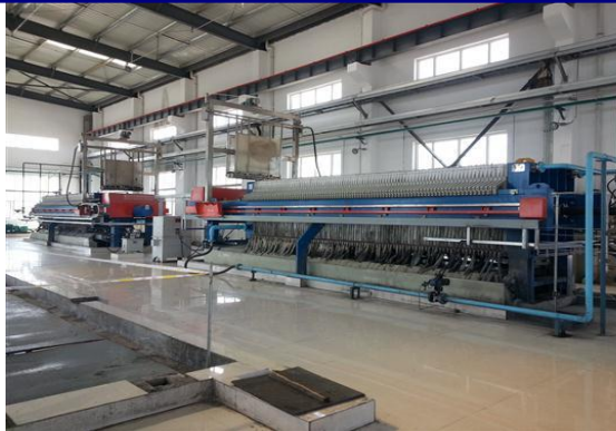
污泥脱水间板框压滤机
