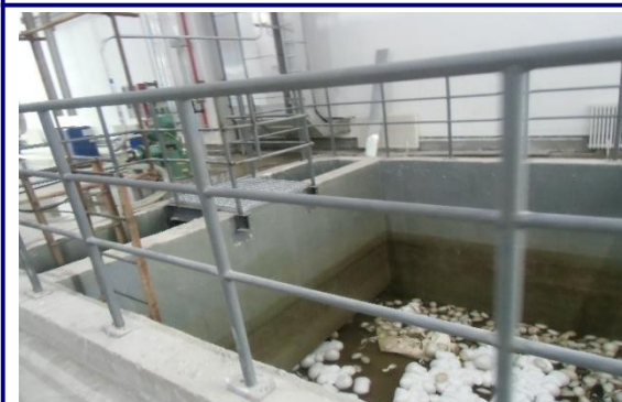
聚丙烯装置废水池
