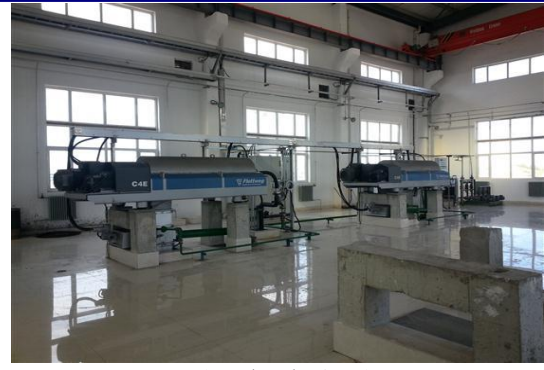
污泥脱水间离心脱水泵
