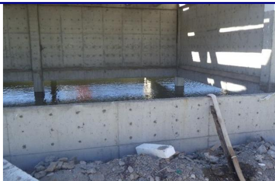
聚乙烯装置撇沫池
