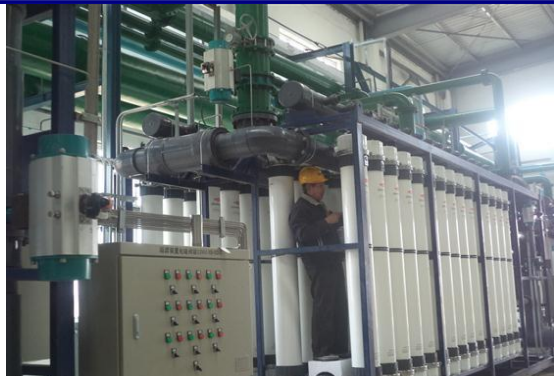
废水脱盐间反渗透装置
